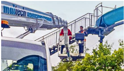
Per Hebebühne werden die Schäden an der Rutsche inspiziert.
